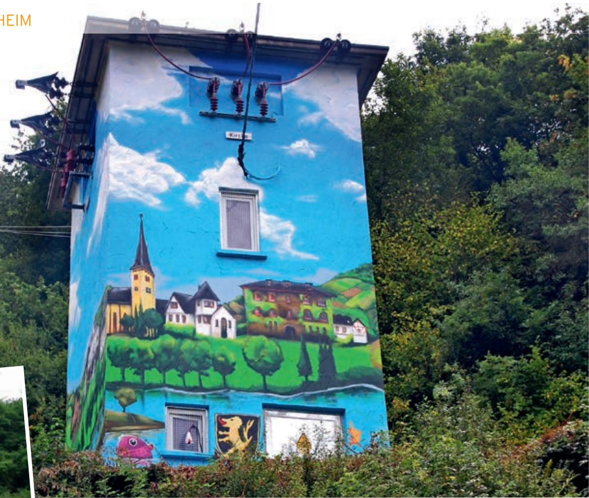
Das aktuell höchste Projekt der JUKUSCH widmete sich der Neugestaltung eines Trafoturmes der RWE in Senheim / Mosel.
